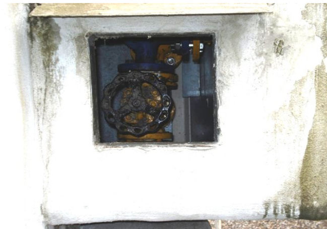
Öffnung zum Betätigen des Wechselventils nach der Entfernung des Wespennestes
