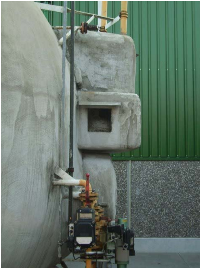
Propantank 50.000 ltr. mit Brandschutzisolierung
