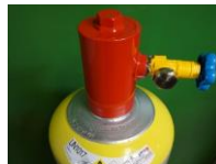
Foto 4 Schutzhülle an der Chlorgas- flasche
